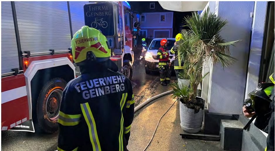
Überflutung Keller | 12. Juli: Pumparbeiten nach heftigem Starkregen und örtlichen Überschwemmungen im Ortszentrum der Gemeinde Geinberg.
